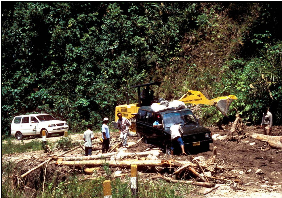
Abb. 7 Reparaturarbeiten an der Verbindungsstrasse zwischen Palu- und Kulawi-Tal nach einem Erdbeben (Quelle: Eigene Aufnahme, 2000)
