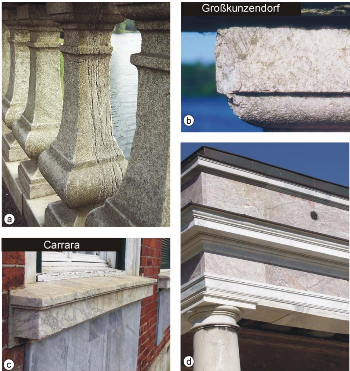
Abb. 8.4: a) Balustrade aus Grosskunzendorfer Marmor (Seeseite) mit zum Teil extremer Verwitterung durch parallel verlaufende Rissysteme. b) Detailansicht eines Balusters mit Substanzverlust an den Bauteilkanten durch Ausbrechen von Bruchstücken. c) Fensterbank aus Carrara Marmor mit starker Reliefbildung aufgrund deutlicher Rückwitterung der hellen Gesteinsbereiche. d) Architrav mit darüber liegender Attika, gegliedert durch Verwendung verschiedener Marmorsorten (vgl. Abb. 8.1b).
