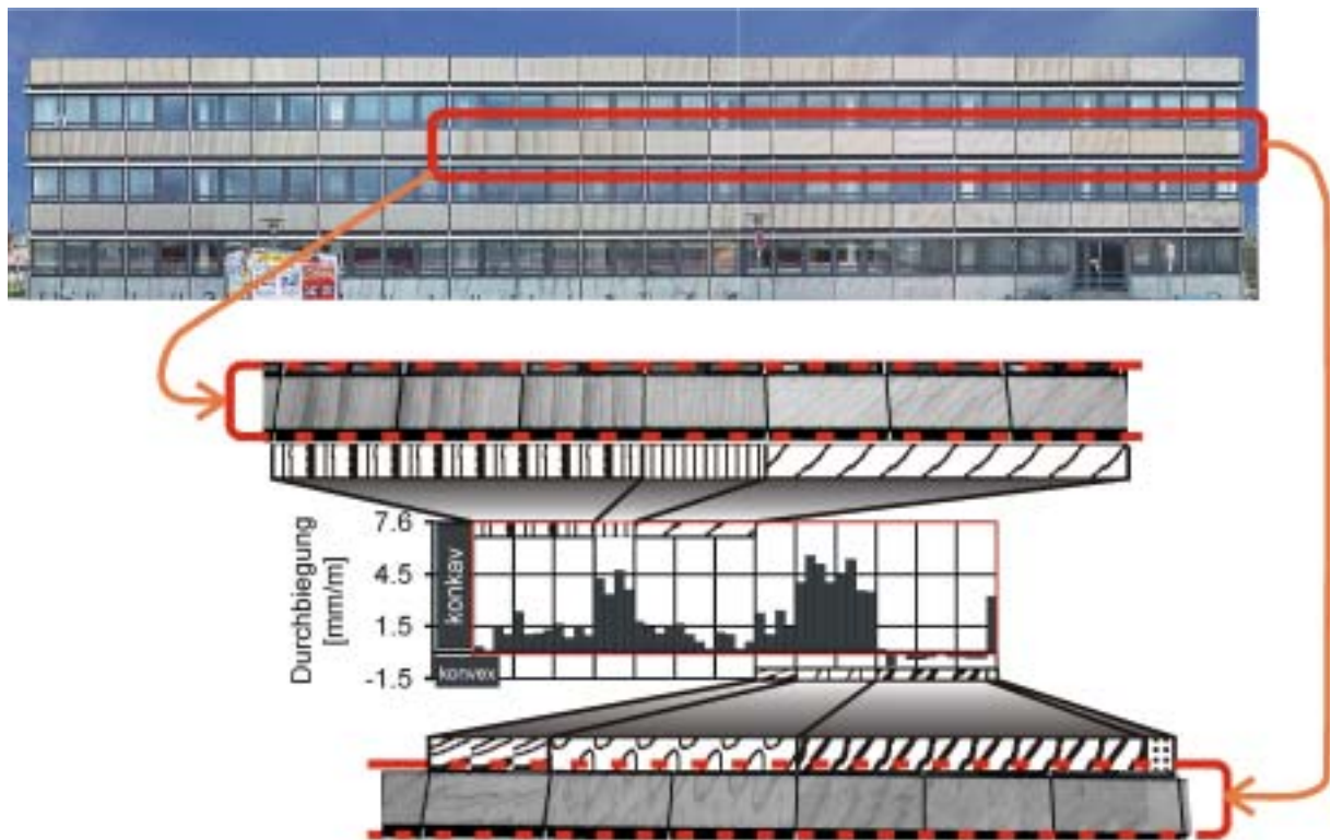
Abb. 4.11: Zusammenhang zwischen der Schnittlage der Fassadenplatten und dem Grad der Verbiegung am Beispiel der dritten Fassadenzeile der Nordfassade des Oeconomicums.
