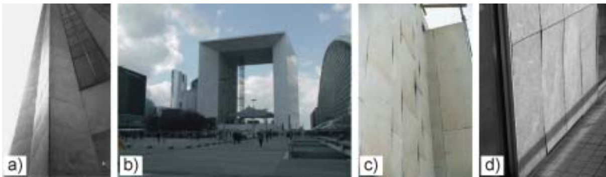
Abb. 2.8: Prominente Beispiele von Gebäuden mit verbogenen Fassadenplatten: a) Das Amoco Building in Chicago (aus Logan 2004), b) der Grande Arche de la Défense in Paris, c) die Finlandia Hall in Helsinki (um 1999) und d) das St. Marien-Hospital in Lünen (Balkon).
