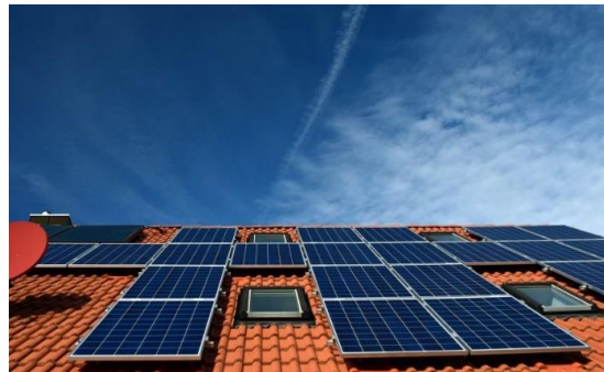
Abbildung 1: Photovoltaikanlage auf einem Hausdach (ulleo, 2017)
