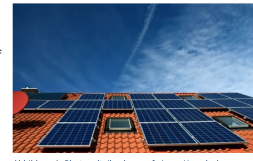
Abbildung 1: Photovoltaikanlage auf einem Hausdach
