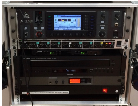
Abbildung 11: Zentrale Steuereinheit des SOTOS.
